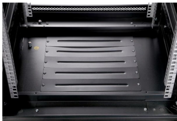
Zaślepienie otwory w podłodze do wprowadzenia kabli
